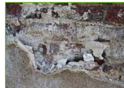
Typischer Schaden durch Salzausblühungen
