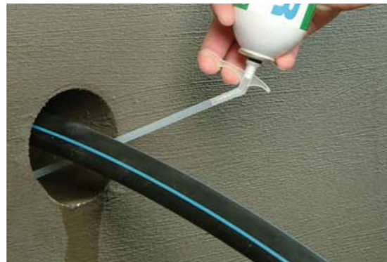
Ein PU-Schaum wird injiziert um einen Rückhalt für KÖSTER KB-Flex 200 zu installieren.
